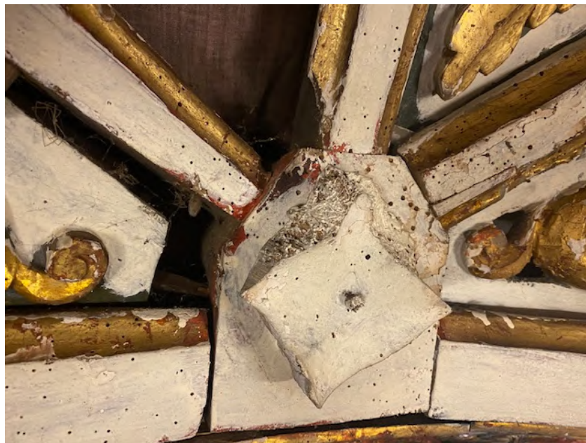
Partes de la cúpula de la hornacina al inicio de su tratamiento
