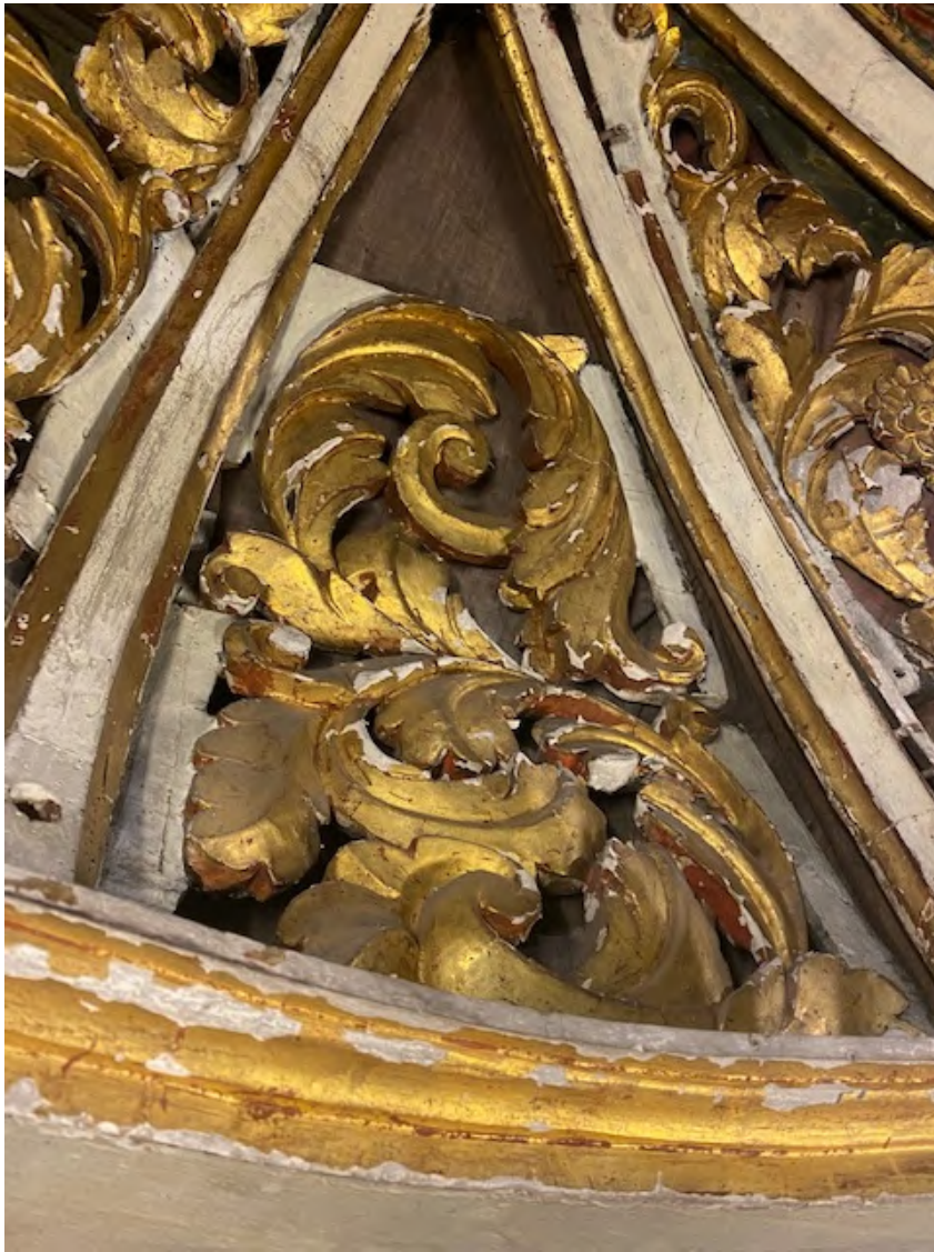
Estado del segundo plemento de la cúpula empezando por la derecha
