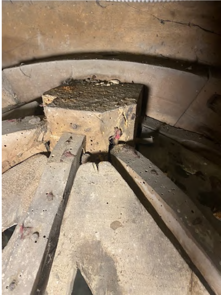
Detalle de la clave de la cúpula desde la zona trasera del retablo, antes de ser limpiada y desinsectada
